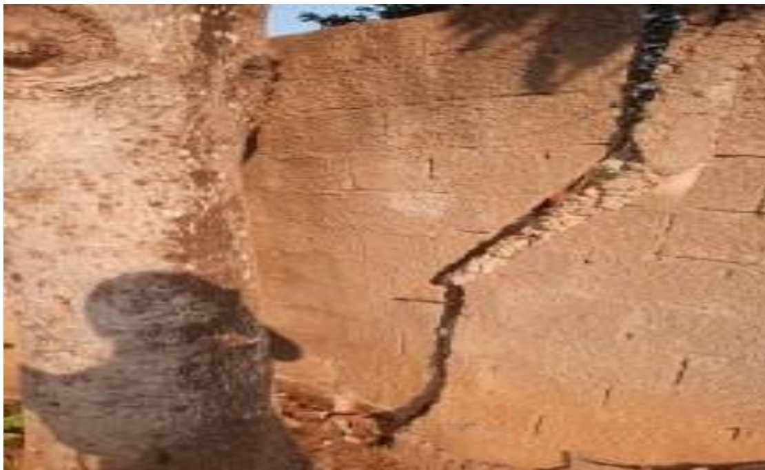
Anexo 2: pé de árvore da espécie frutífera mangueira, já rachou o muro de sua residência
